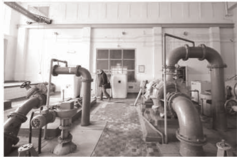
Zdjęcie z wnętrza sali pomp, autor: Jakub Trzaskowski
