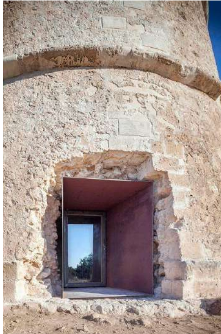
Rys. 100. Restauracja zamku – przykład interwencji w otworze okiennym z użyciem kortenu [ https://www.designboom.com/architecture/maria-castello-martinez-pi-des-catala-tower-restoration-formentera-spain-05-24-2017/ , dostęp 10.10.2021]
