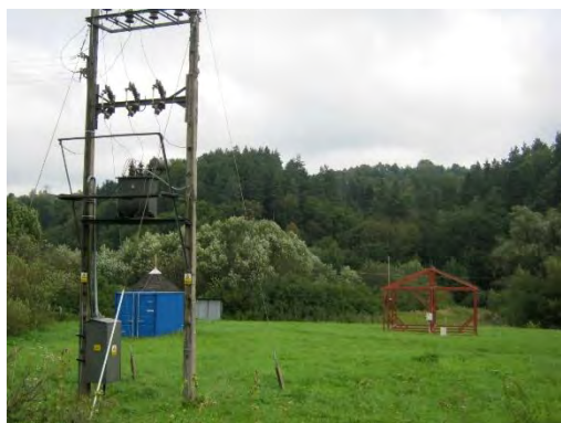
Rys. 3. Słupowa stacja transformatorowo-rozdzielcza z przyłączoną linią napowietrzną
